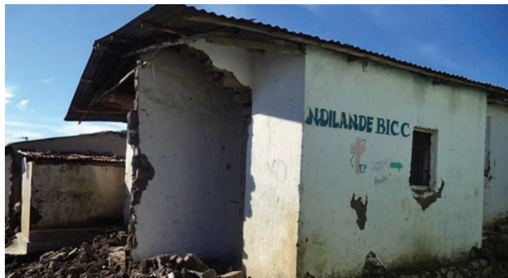
El edificio de la Iglesia de los Hermanos en Cristo Ndirande de Malawi, sufrió daños a causa de intensas precipitaciones en enero de 2015. Según un informe del pastor Francis Kamoto, el santuario del edificio se salvó, pero otras partes de la estructura fueron destruidas.
